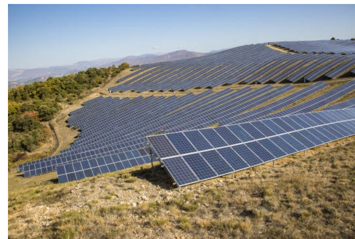
Une fraction des 200 hectares de la centrale de Les Mées, Alpes de Haute-Provence.
